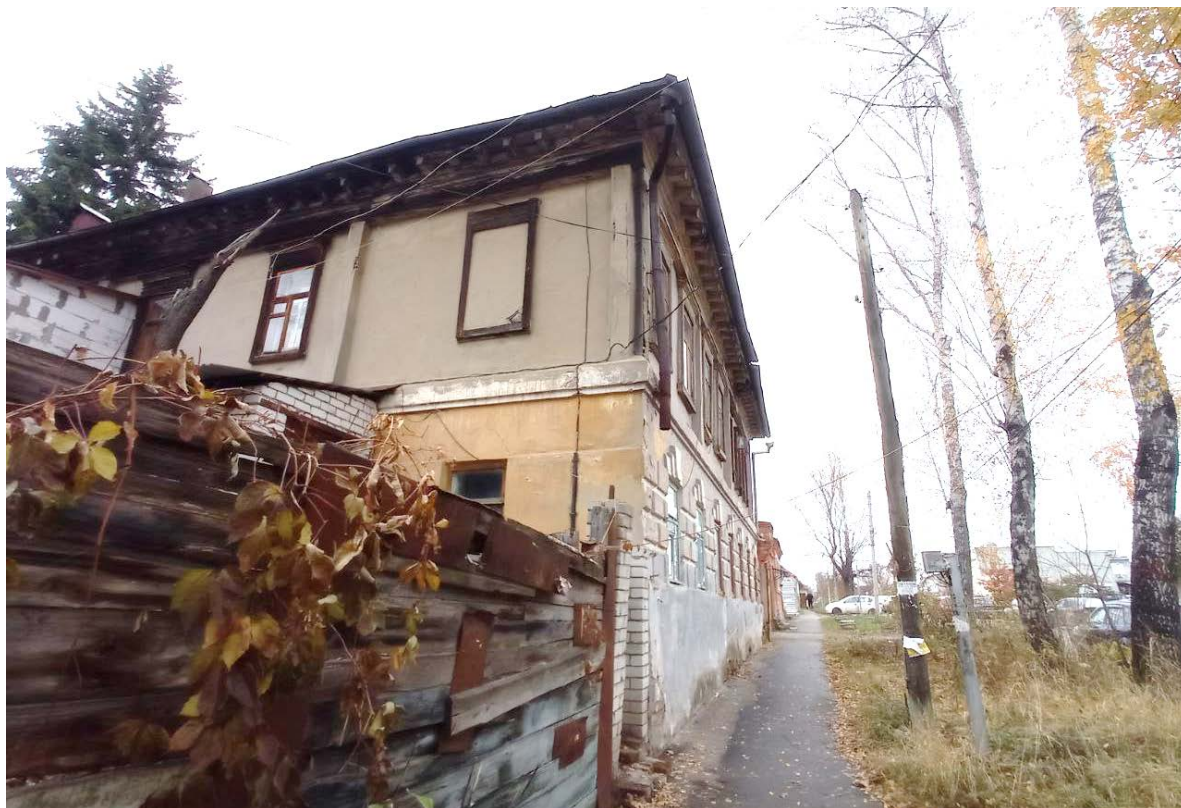
Фото 9. Выявленный объект культурного наследия «Дом жилой», г. Курск, ул. Карла Либкнехта, 30. Фрагмент южного фасада. Фото Коротеевой Е.В. 11.11.2024
